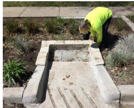
Concrete Forebay (Kansas City Water)
